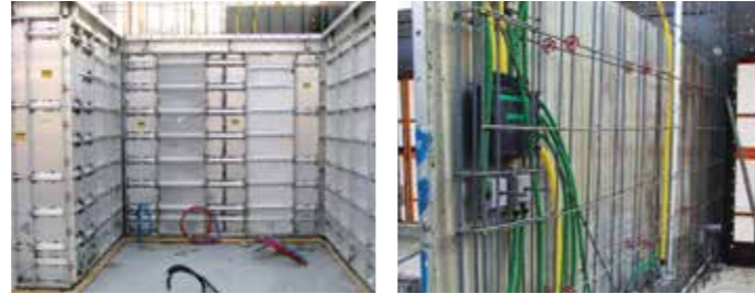
+2 Instalación de componentes eléctricos, de fontanería y acero de refuerzo. Instalación de I/C y paneles de pared.
